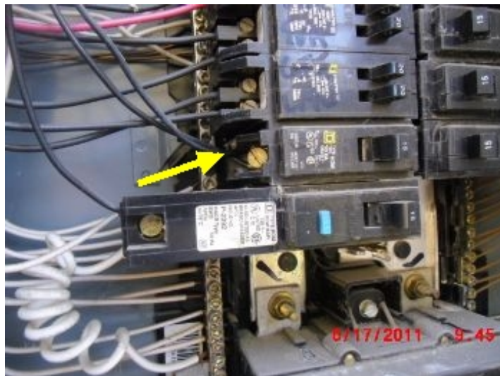
One 15 amp breaker double lugged-two wires in lieu of one(2)
